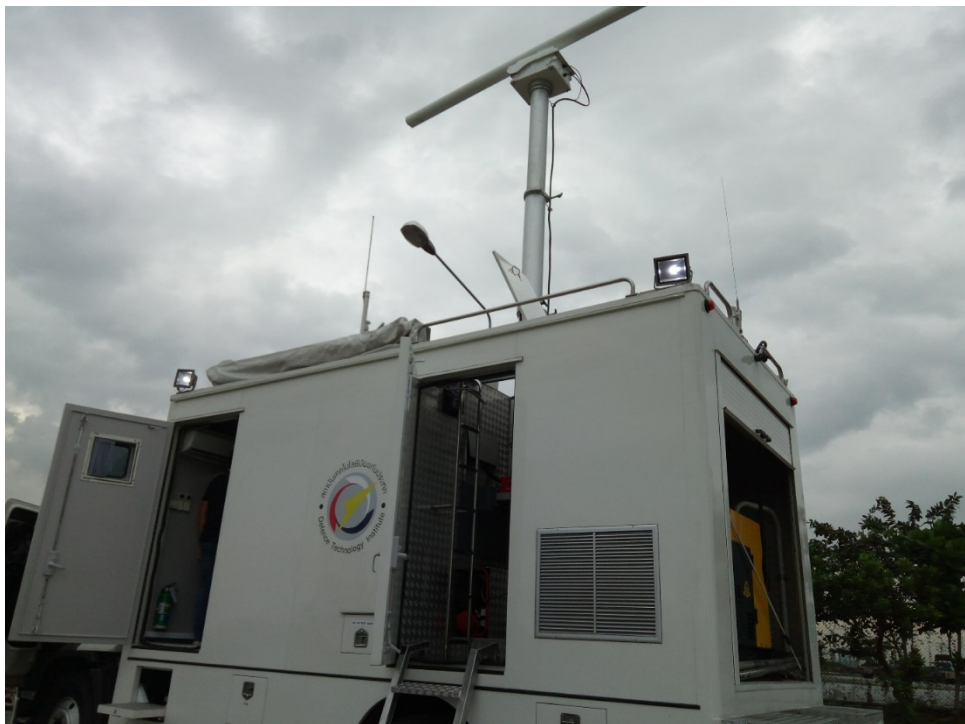
ภาพที่ 4.12 แสดงระบบ VTMS จากภายนอก
